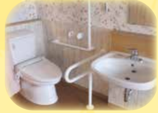
居室内 トイレ・洗面台
